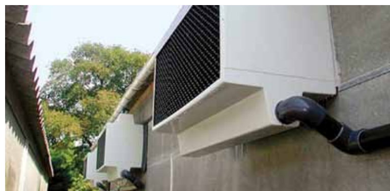
Фото 3. Охолоджувальні водяні панелі
