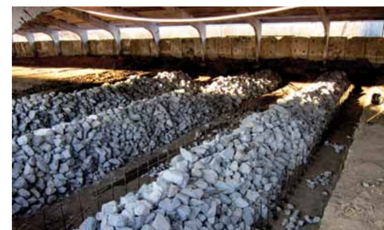
Фото 6. Основні етапи будівництва геотермічної системи вентиляції з розташуванням під свинарником кам'яних подушок
