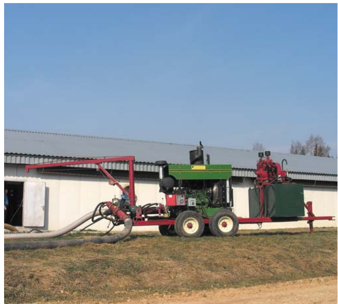
Фото 3. Дизельна насосна станція
